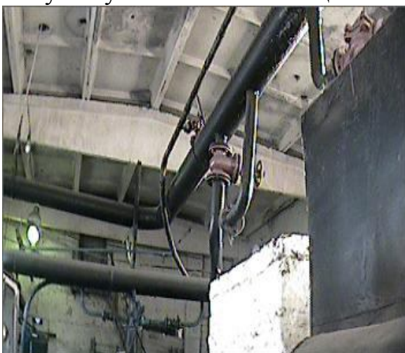
Отсутствует тепловая изоляция
