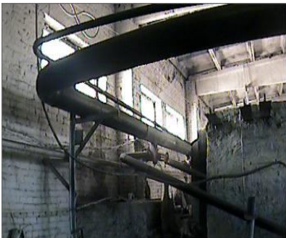
Отсутствует тепловая изоляция
