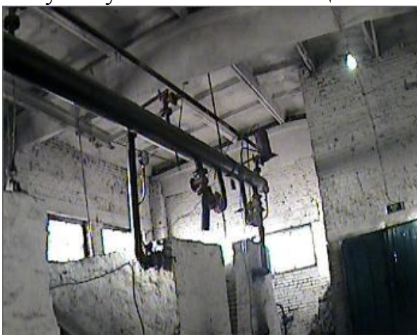
Отсутствует тепловая изоляция
